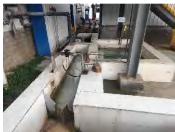
污水处理二站排放口
