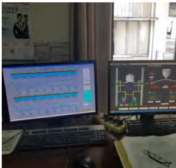
电解除尘排气系统在线监测
