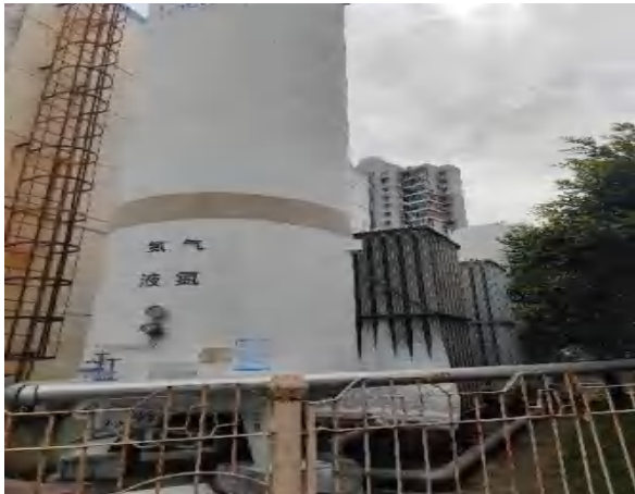
化工库北侧液氮储罐
