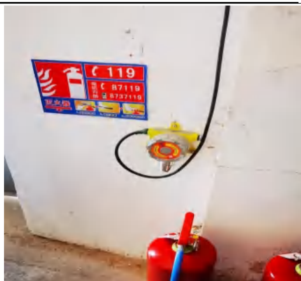
电泳漆储存间可燃气体探测器
