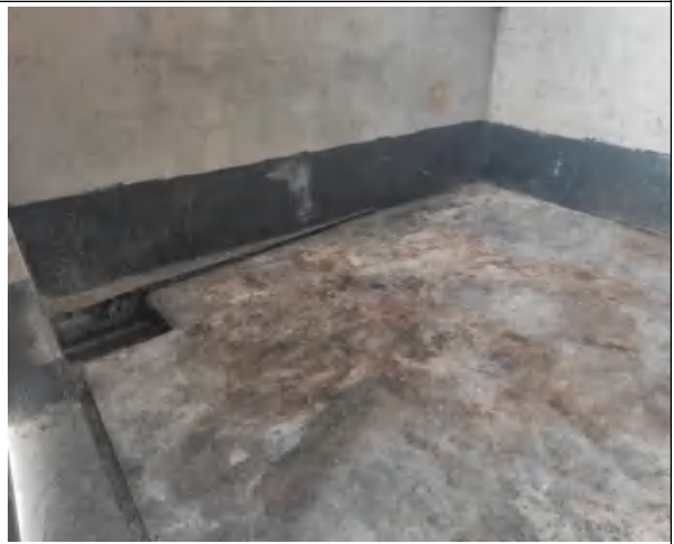
危险贮存库泄漏导流沟和收集池
