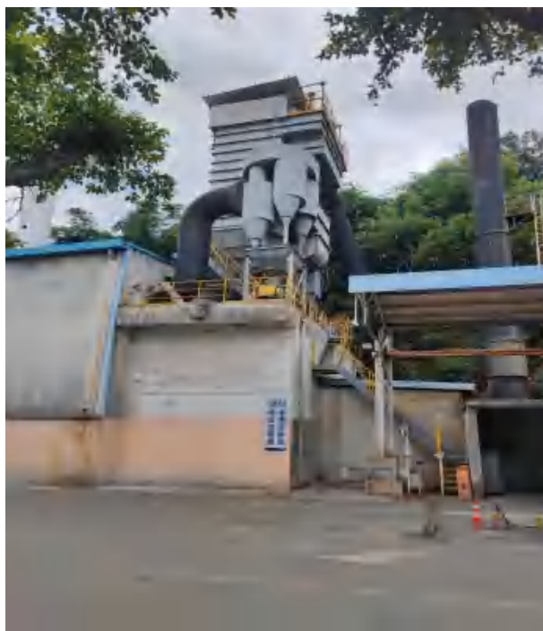
铝渣废气除尘系统
