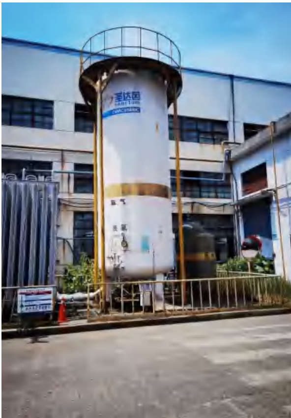
熔铸 1#、2#生产线北侧液氮储罐
