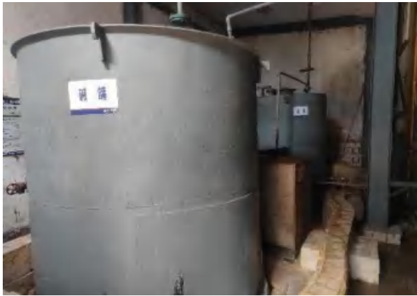
污水处理二站酸罐和碱罐
