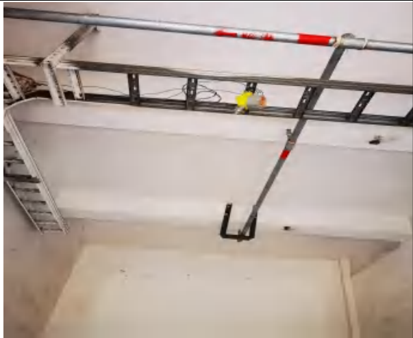
乙炔瓶储存间探测器
