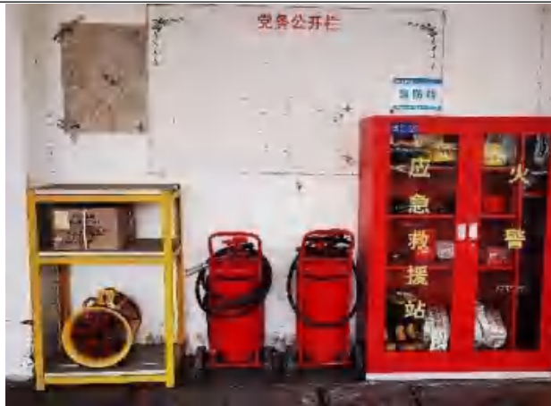
生产现场消防器材
