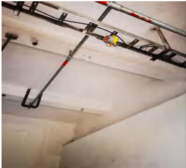
氧气瓶储存间探测器
