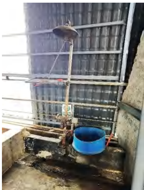
污水处理一站罐区洗眼器
