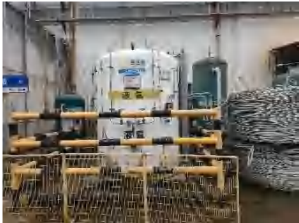
华银厂区氩气储罐
