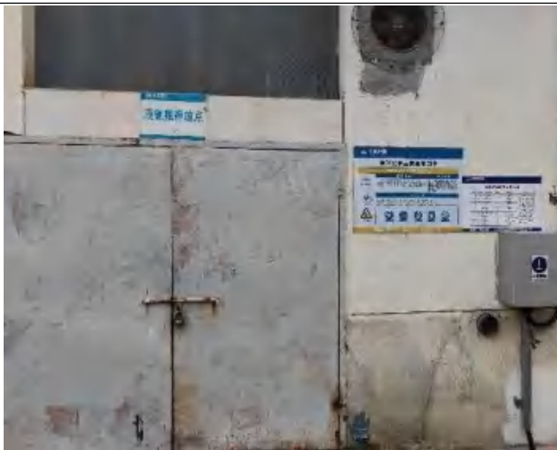
液氨瓶储存间
