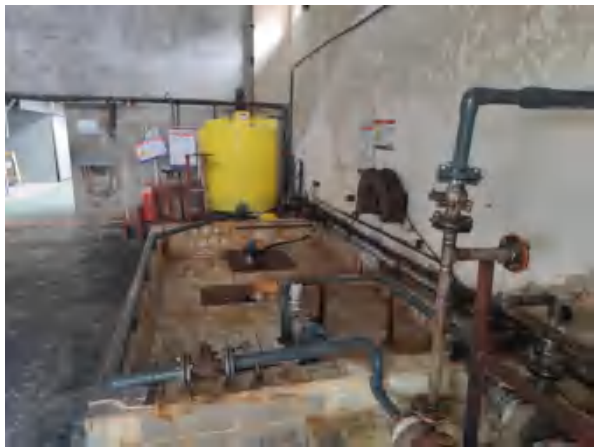
氧化二车间地下碱液罐
