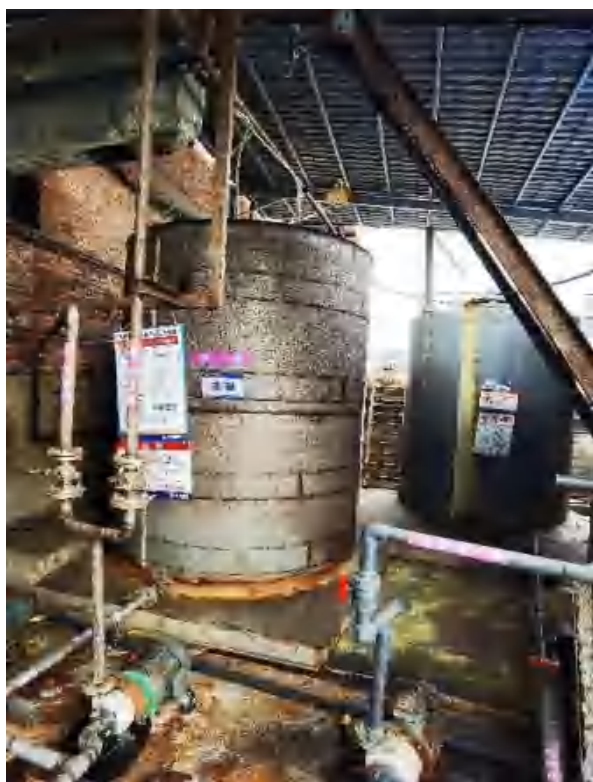
污水处理一站液碱罐
