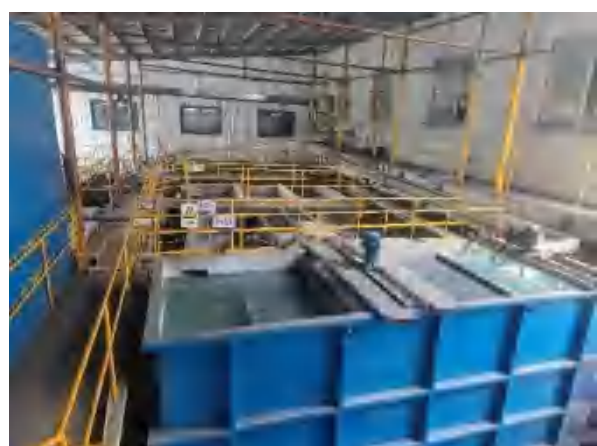
污水处理二站处理池
