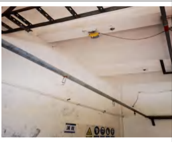
液氨瓶储存间探测器和喷淋设施
