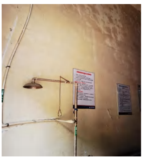
华银氧化车间罐区洗眼器
