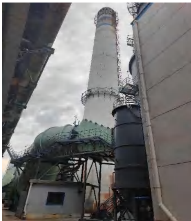
45m 电解车间烟囱（废气排放口）
