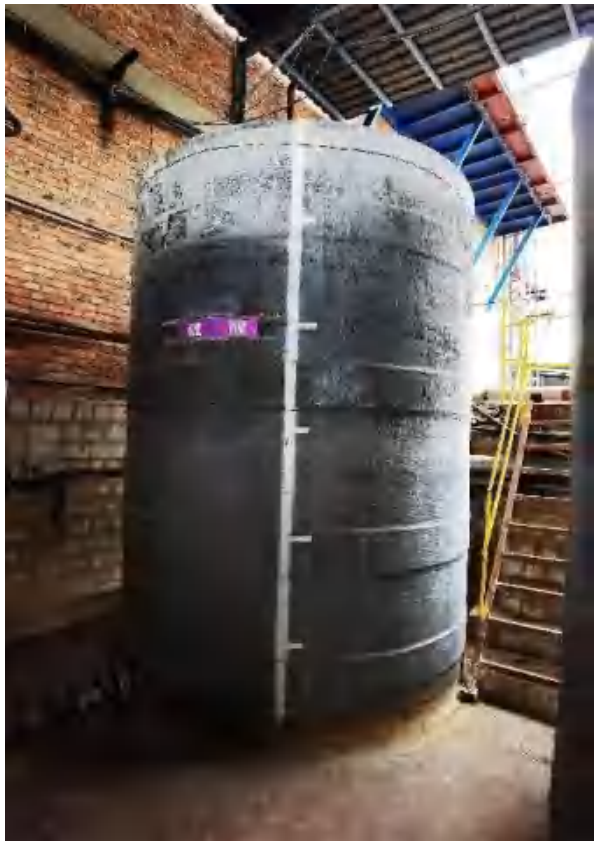
污水处理一站硫酸罐
