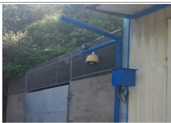
厂区视频监控
